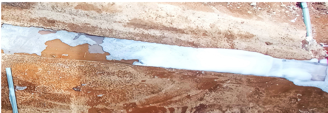
Figura 13 Canal de captación de agua residual y retención de sólidos.
