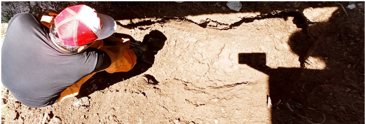
Figura 09 Excavación de hoyo para instalación de Sistema Automatizado de Tratamiento y Reutilización de Aguas Residuales de Autolavado "EL CHATÍN"
