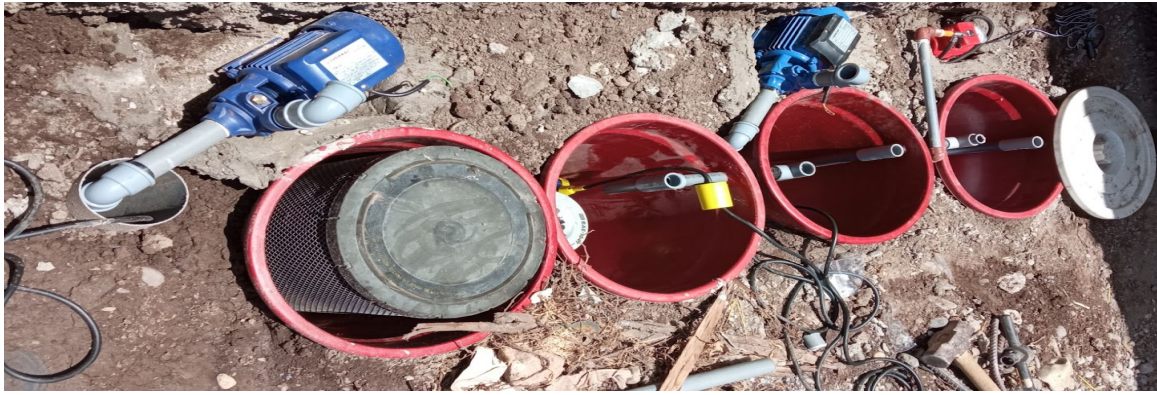
Figura 11 Instalación de equipos eléctricos para el sistema automatizado del sistema de tratamiento y reutilización de agua residual del autolavado "EL CHATÍN"
