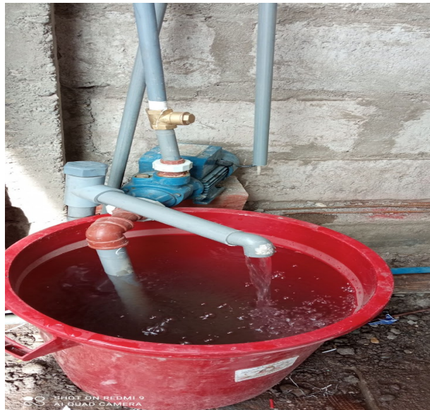
Figura 17 Depósito de agua residual tratada para reutilización.
