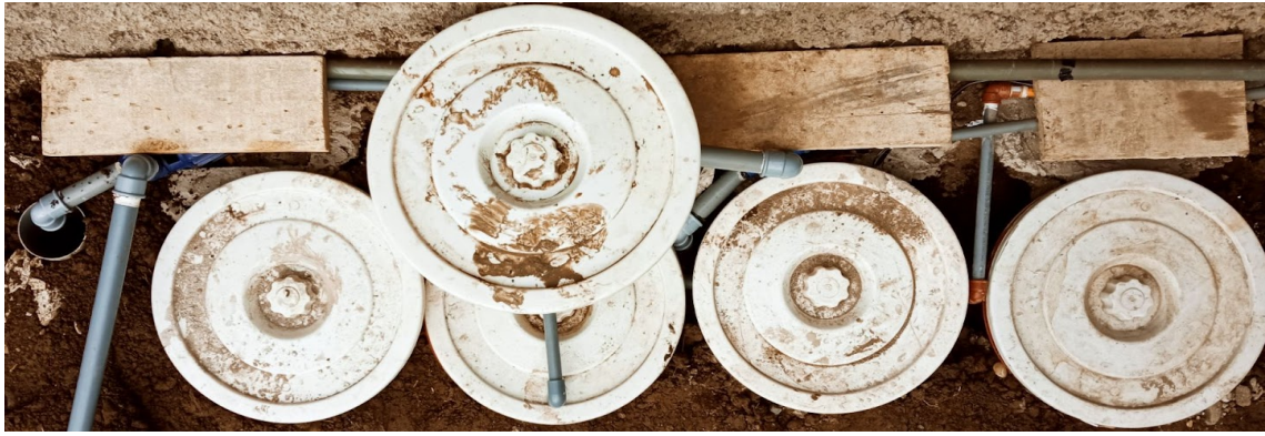
Figura 14 Resultado final de instalación de sistema automatizado de tratamiento y reutilización de agua residual.
