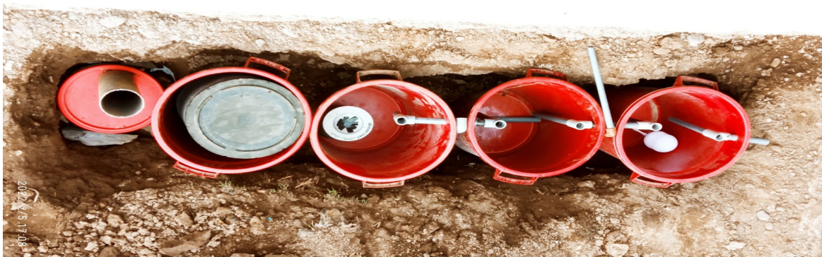
Figura 10 Instalación de depósitos de plástico de 50 lts. para el sistema de tratamiento de agua residual de autolavado "EL CHATÍN"
